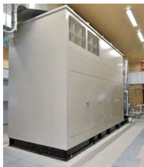
ガスエンジン コージェネレーション(CGS) 400kW×1台
