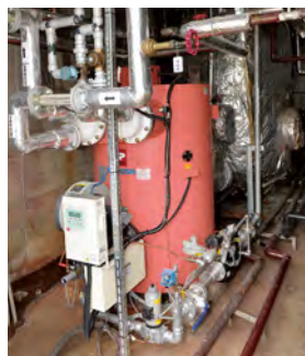
天然ガスボイラー 465kW×2台
